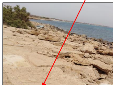
الصورة (18) جرف وتآكل جدران
